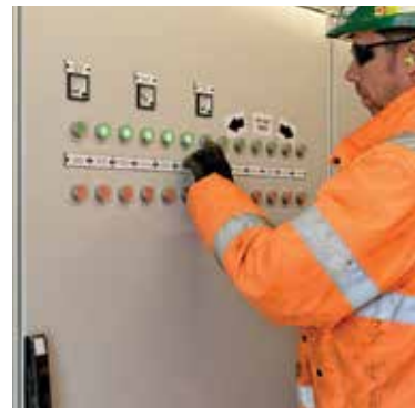
Центральная панель управления для типовой установки большой промывочной установки
