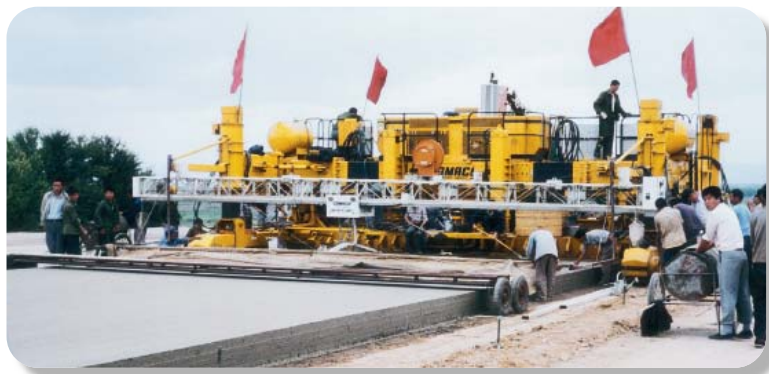
Подрядчик выбрал четырехгусеничный бетоноукладчик GHP-2800 для скоростного строительства дорожного покрытия вблизи Датонга, Китай.
