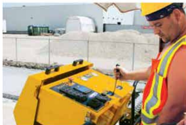
Оператор работает на площадке управления GP2400
